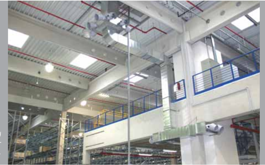
Colt-Systeme sorgen bei DAF Ungarn, Budapest – Ungarn für optimale Raumluftbedingungen.
